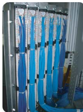
Installation von bis zu sechs Standard 28-Port Cat-5 oder Cat-6 Patchfeldern.
