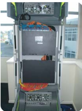
Installation von bis zu drei 48-Port Netzwerk Switche** in einem Armarac.
