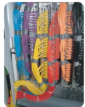
Einfaches Kabelmanagement von bis zu 144 1,5m Standard Patchkabel.
